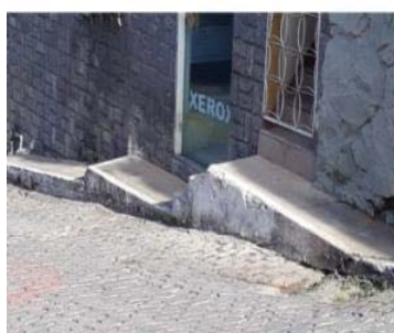
Falta de nivelamento entre as calçadas
